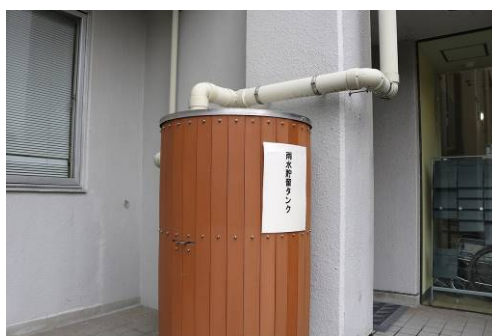
雨水貯留槽（相模原市環境情報センター）
